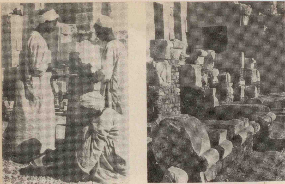
Specjaliści arabscy przy ustawianiu kolumn sali hypostylowej świątyni Hatszepsut na trzecim tarasie (zdjęcie z lewej) i bloki należące do tzw. ściany z posągami na trzecim tarasie świątyni Hatszepsut, przygotowane do rekonstrukcji.
